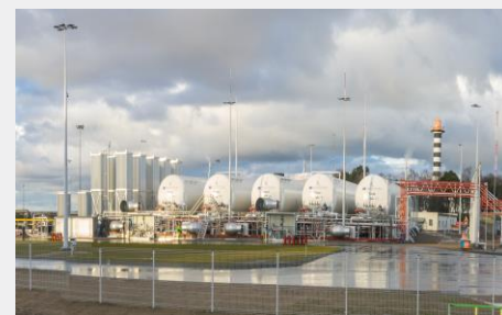
KLAIPĖDA SMALL-SCALE LNG TERMINAL
