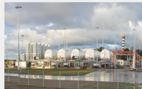
KLAIPĖDA SMALL-SCALE LNG TERMINAL
